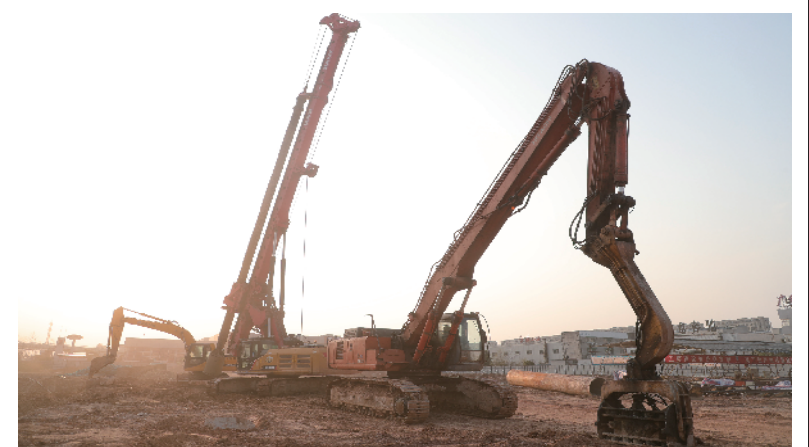
衢江区科教产业园(一期)项目为集总部办公、三馆一中心、校外培训等功能为一体的产业园。项目总用地面积为25732平方米(合38.60亩)，主要建设科教大厦、塔楼及文化艺术中心等，目前，项目基础部分正有序推进。邵秀清/摄
