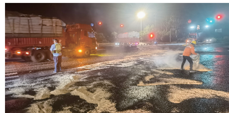
油罐车泄漏 多部门连夜处置
