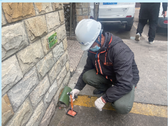
完善防鼠设施
