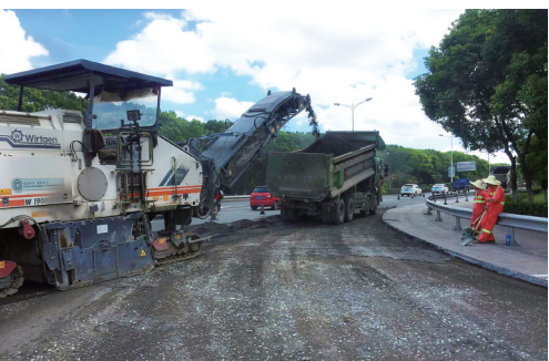
镇海 ▲今年,宁波镇海区交通运输管理中心启动了五条县道维修工程。目前,该工程已经进入尾声,预计12月底前可全部修复完成并投入使用。 □周晓宇/摄影报道
