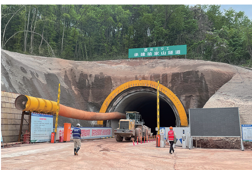
新昌 ▲近日,527国道新昌段一期工程喻家山隧道建设现场,3个班组正在开展掌子面钻孔施工。据悉,该隧道为单线双洞,其中左洞全长602米、右洞753米,于去年10月份进洞施工,目前累计已完成总体形象的40%,预计今年10月底之前可全线贯通。 □徐云锋/摄影报道
