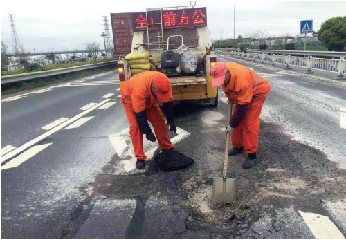
温岭 ▲近日,温岭市公路事务中心加强巡查,重点对管养路段公路桥涵、防排水设施、辖养路段等进行了检查,及时消除安全隐患,确保行车安全。 □林媛/摄影报道
