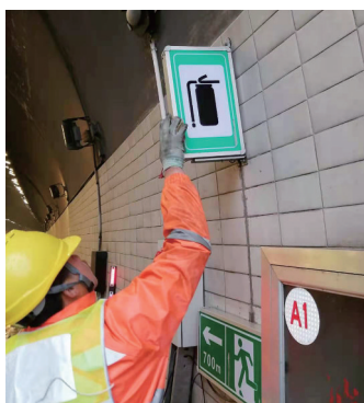
绍兴 ▲近日,浙江交通集团绍兴管理中心运行分中心组织相关人员对马吞岭隧道的机电设施进行了一次清洁整修维护,确保隧道设施整洁、完好,维护正常安全运行。 □李洪宇/摄影报道
