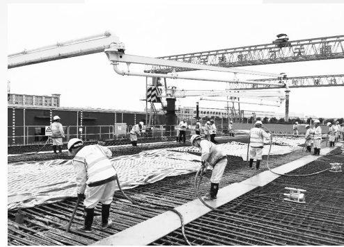
宁波 ▲4月30日凌晨两点，在项目部梁场全体人员的喝彩声中，最后一方混凝土缓缓注入模板中，标志着宁波象山湾疏港高速完成了全线箱梁预制任务。 □廖文柳 杨觉余
