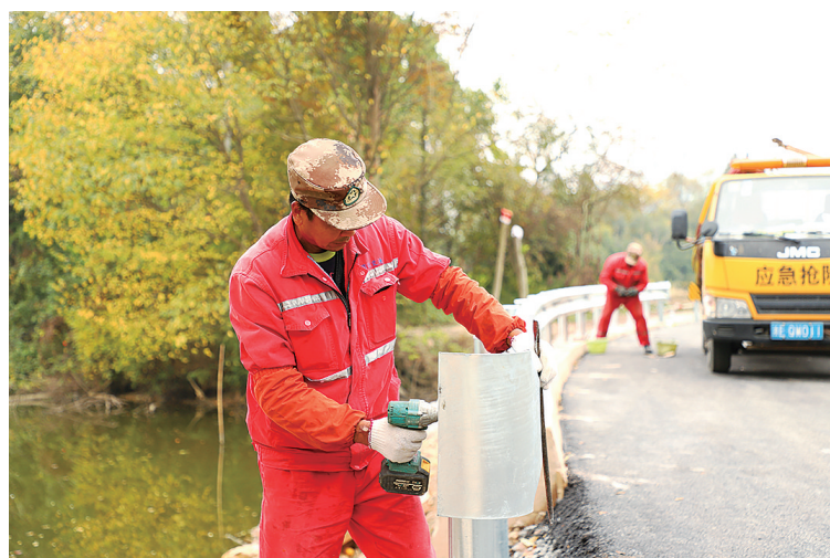
长兴 ▲近日,经过两年多时间的建设,长兴县吴山大桥改建主体工程完工,目前正在进行桥面沥青混凝土铺装工作和引桥护栏的安装工作,预计今年年底完工通车。 □李卫兵
