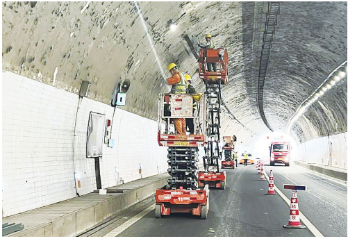
临海 ▲近日,临海市普通国道隧道维修加固工程进入尾声。该市公路与运输管理中心集中力量对黄土岭隧道开展了照明设施更换、供配电设施改造等工作。 □郭飘飘 郑泽鑫
