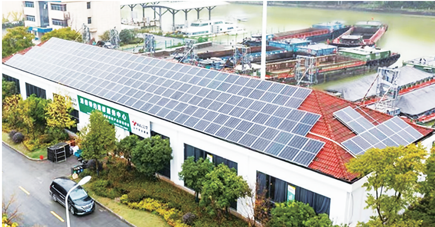
屋顶光伏板。高敏/摄
