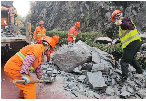
开化 ▲11月23日,开化县油古线6K+090解元岭隧道附近路段突发山体塌方,大块岩石占据三分之一的路面,开化县池淮公路站立即组织养护人员和相关机械前往现场抢险。 □徐曙光
