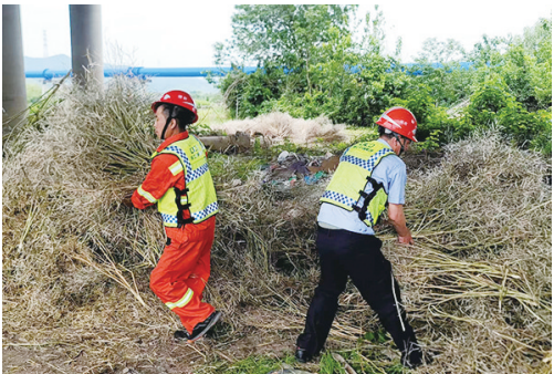
绍兴 ▲近日,浙江交通集团高速公路绍兴管理中心联合辖区交通执法队,对辖区内堆放着稻草、秸秆等杂物的一处桥下空间进行了集中清理整治,消除公路桥梁安全隐患。 □李洪宇
