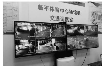
临平体育中心场馆群交通调度室
