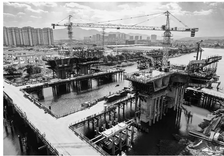
在甬台温高速改扩建工程台州南段项目黄岩1号高架桥施工现场,工人们正在为桥梁的底腹板绑扎钢筋。该项目是全省高速路网“一纵”的组成部分,全长约40.2公里,目前正全速推进。
