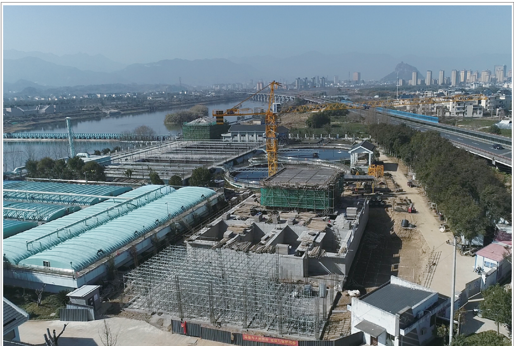
县污水处理厂清洁排放技术改造工程正在加快建设,争取早日完工并投入使用。该项目建成后,日处理水量 4.5 万吨,经过微生物处理、絮凝沉降等 9 道工序后,处理水排放按照《城镇污水处理厂主要水污染物排放标准》执行,将有力提升县域污水处理水平和生态环境综合治理能力。
