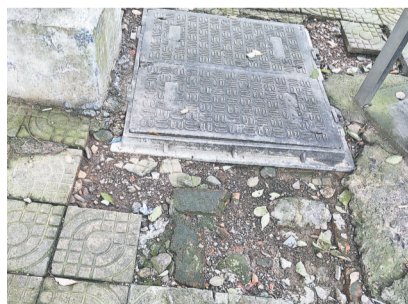
人行道破损严重
