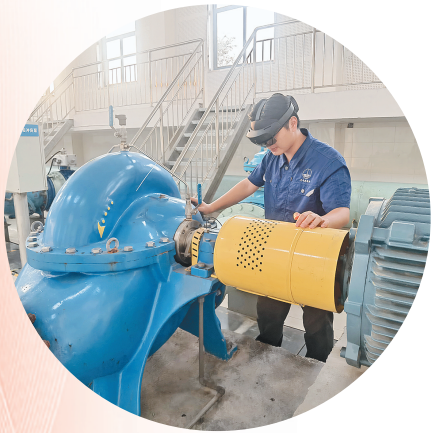
数字水厂 AR 巡检
